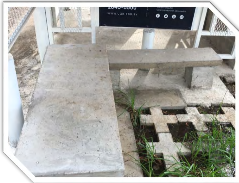
Estado de placa en paredes
