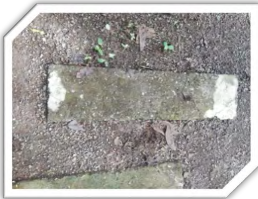
Estado de placas en pisos con desgaste y moho
