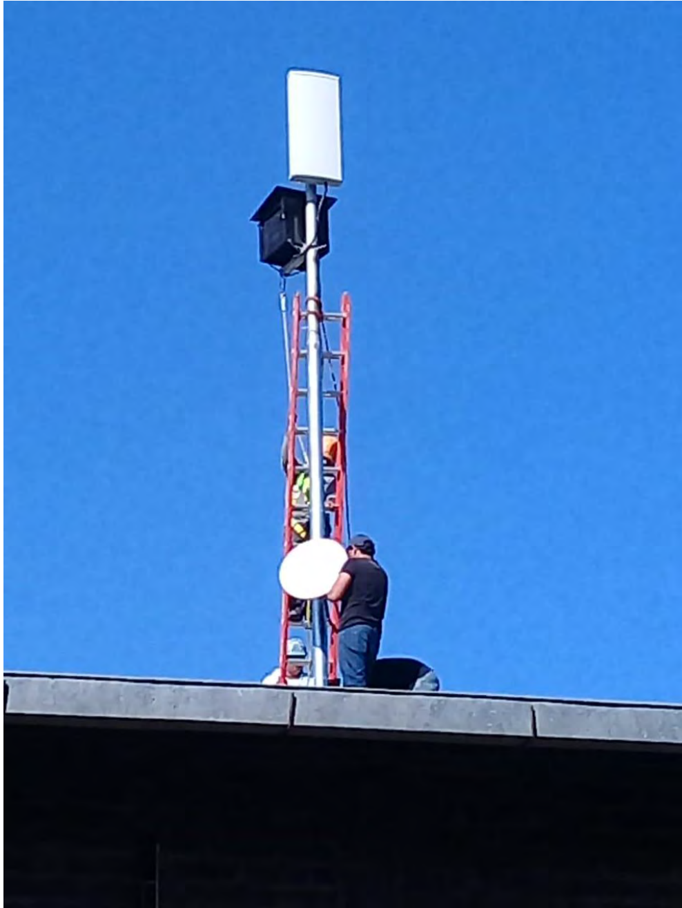
Fig. 2 Instalación de transmisor en UGB Usulután.
