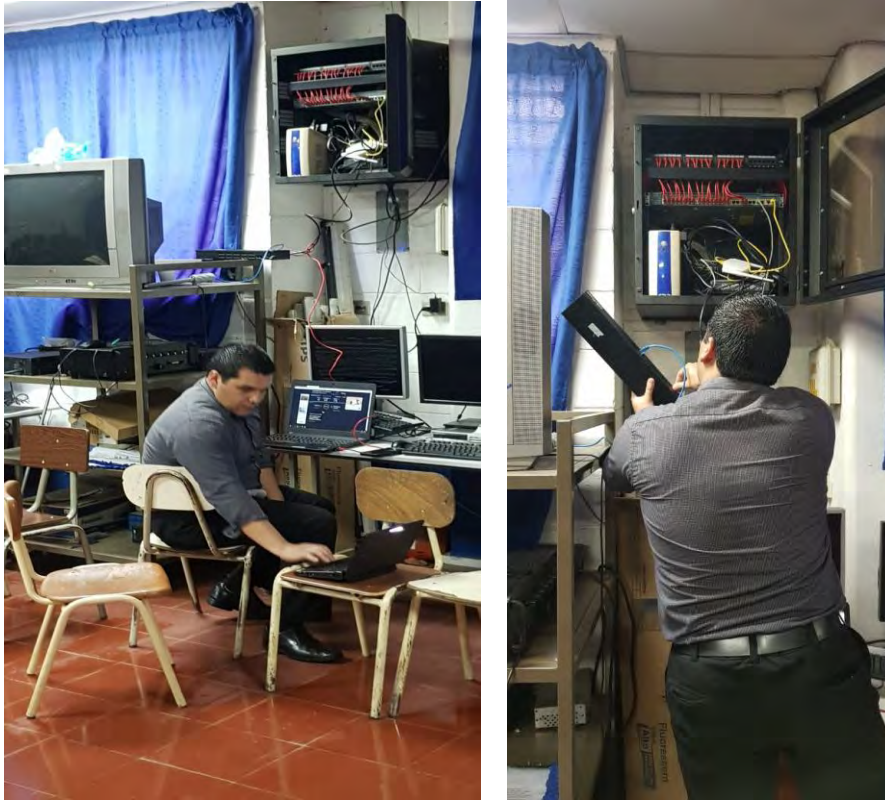
Fig. 7 Instalación de Equipos de Red en Centro Escolar Confederación Suiza.
