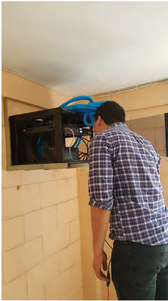
Fig. 4 Instalación Equipos de Red en Centro Escolar Cantón Hato Nuevo.
