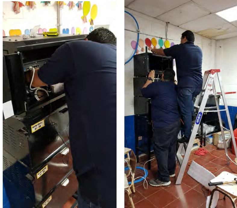
Fig. 9 Instalación de Equipos de Red en Complejo Educativo Ofelia Herrera.
