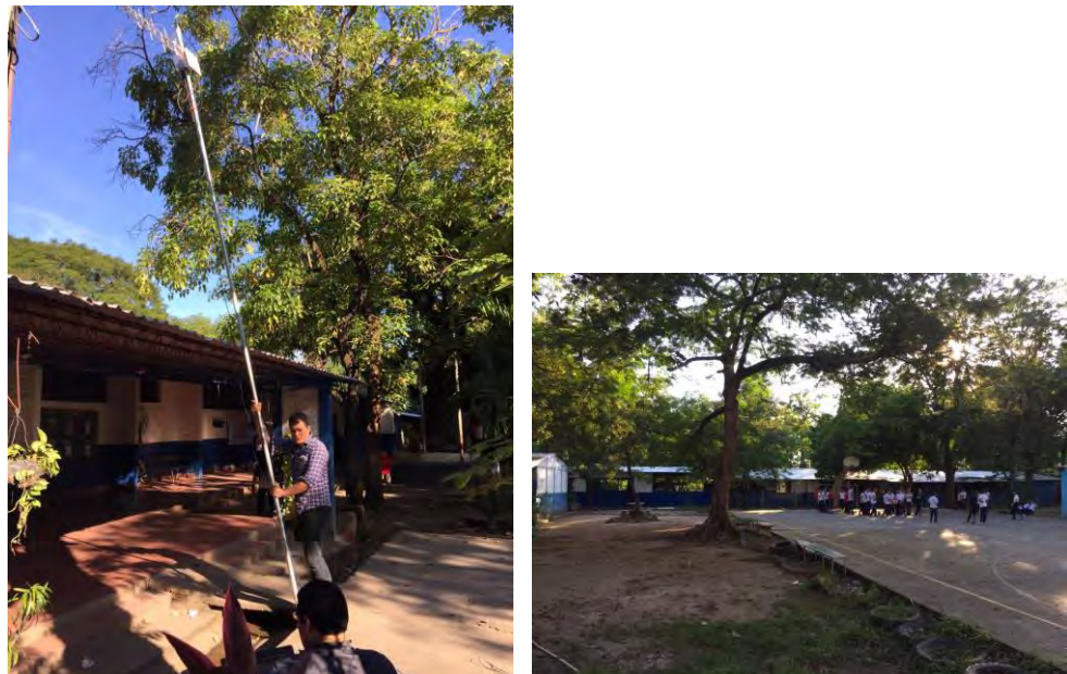
Fig. 12 Instalación de Antena de TVWS en Centro Escolar Cantón El Papalón.
