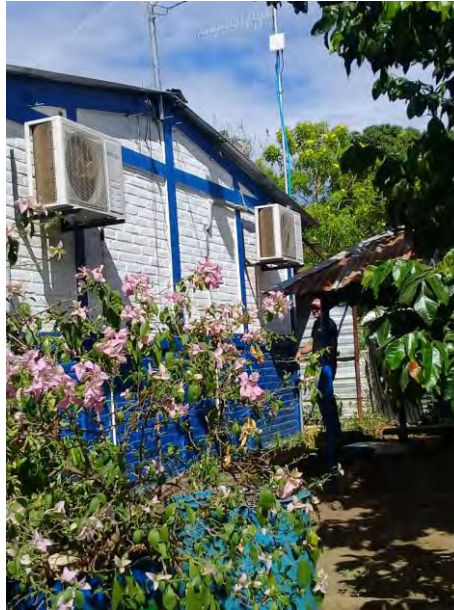
Fig. 13 Instalación de Antena de TVWS en Centro Escolar Cantón Mejcapa.
