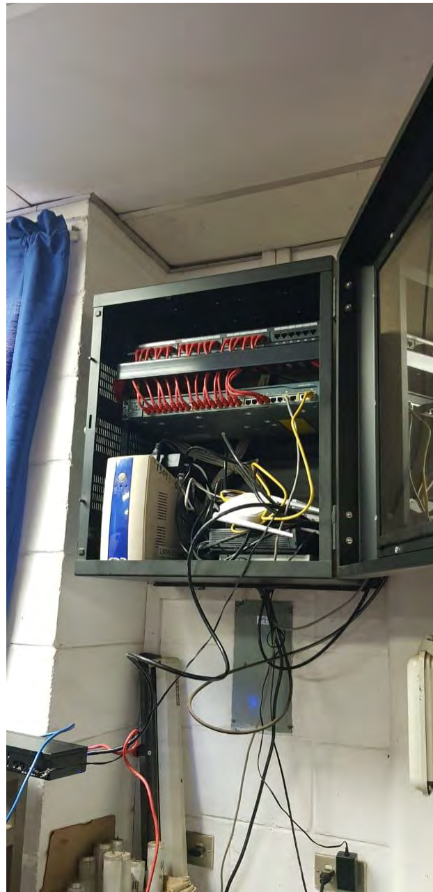
Fig. 8 Equipo de Red Instalado en Centro Escolar Confederación Suiza
