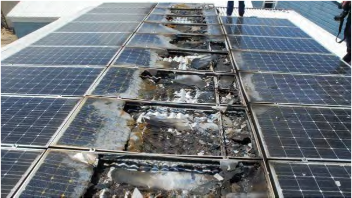
Ilustración 12: Paneles solares dañados
