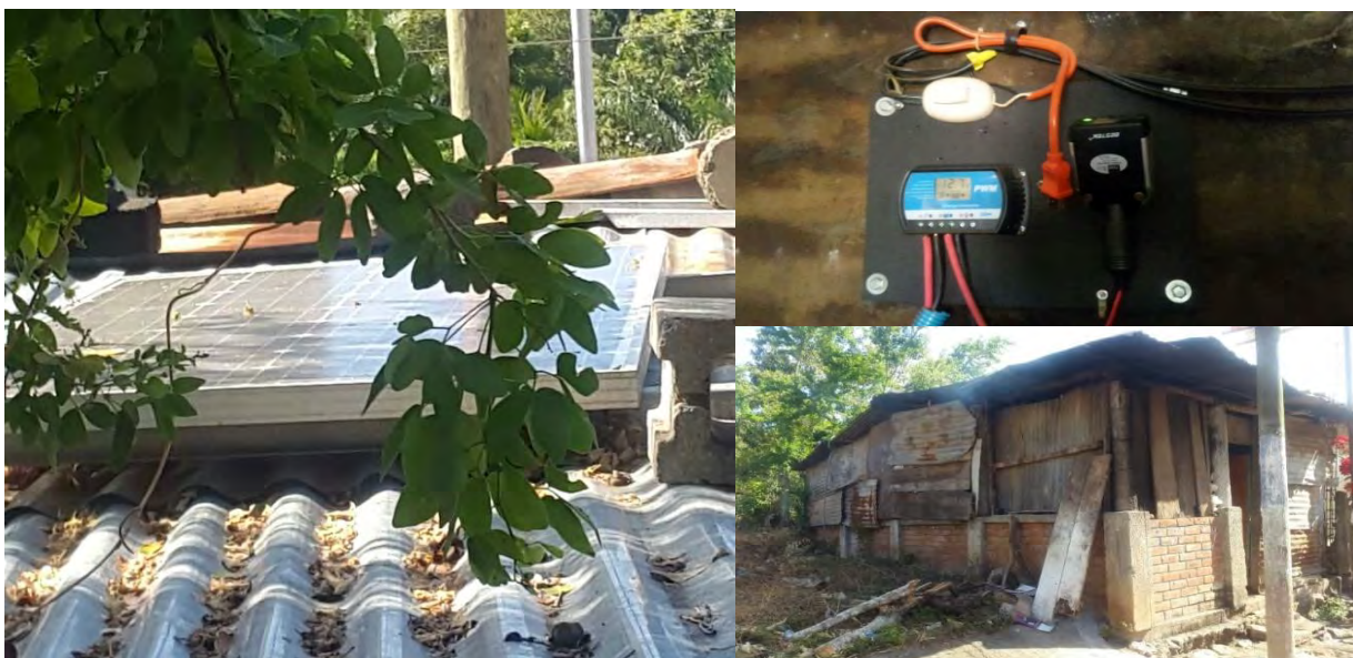
Ilustración 9: Sistema aislado en una vivienda de la zona rural, recopilada durante la investigación “Medición del grado de aceptación en el uso de energías renovables en hogares y empresas” – 2017.
