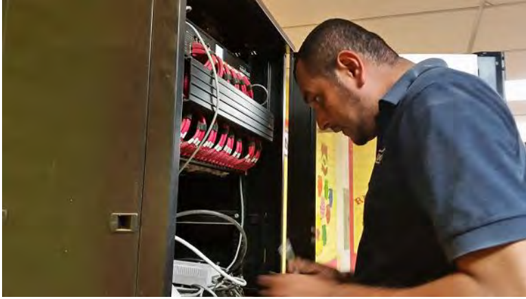
Ilustración 10: Configuración de router y equipo de red 10/04/2019
